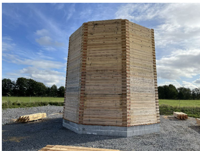
Ventilationstorn för tunnelbanan som även fungerar som boplatser för fladdermöss och tornseglare.
